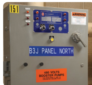
Kezelőpultok és villamos panelek címkéi
